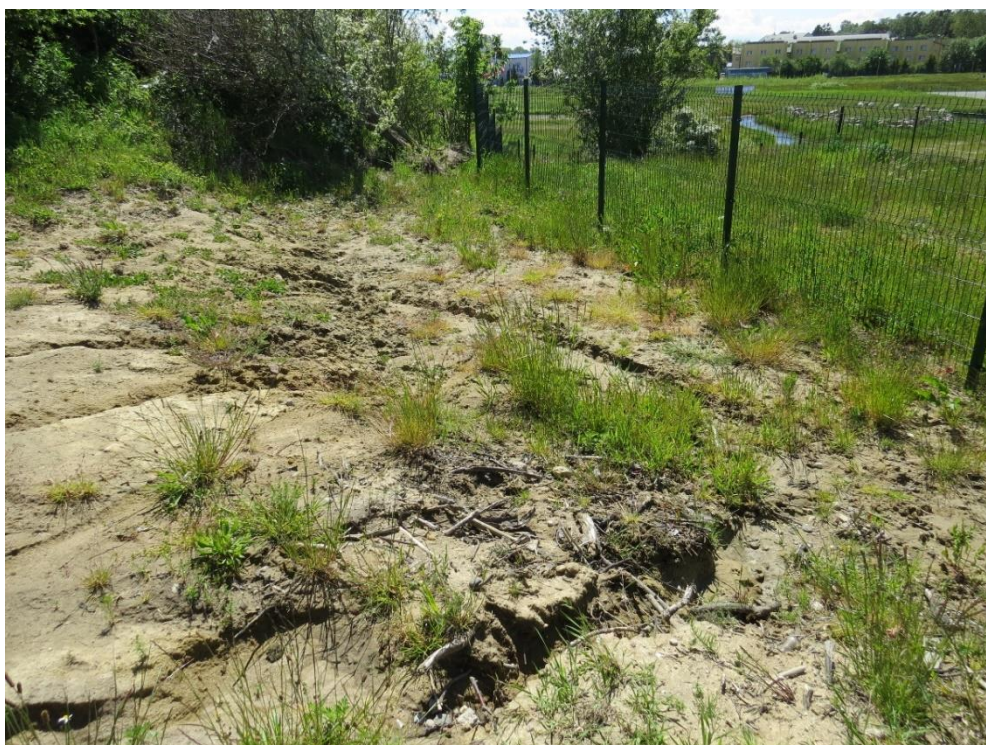
Fot. 25. Granice terenu Planu i sąsiedztwo. Teren elementarny 13US,UT – erozja spływających wód opadowych z ujścia istniejącego rowu na niższą terasę w kierunku wybrzeża. Poniżej wzniesienia, wody opadowe chwywane są w wykopane rowy. Widoczne jest to na zdjęciu powyżej. Na rysunku Planu widoczne jest miejsce ujścia rowu poza teren opracowania Planu. Wody z opadów magazynowane są w zagłębieniach terenu na niższej terasie (autor: S. Jurzyk-Nordlów 2022 r.).
